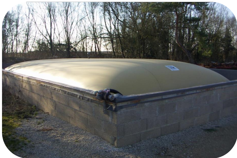
Zbiornik 70 m 3 retencyjny na ścianie
